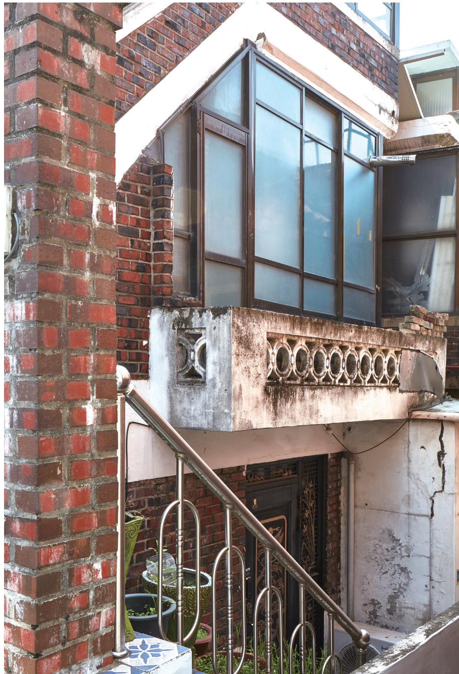
공사전(위) 건물 뒷편 모습. 오염된 난간과 외벽의 모습이 보인다.
